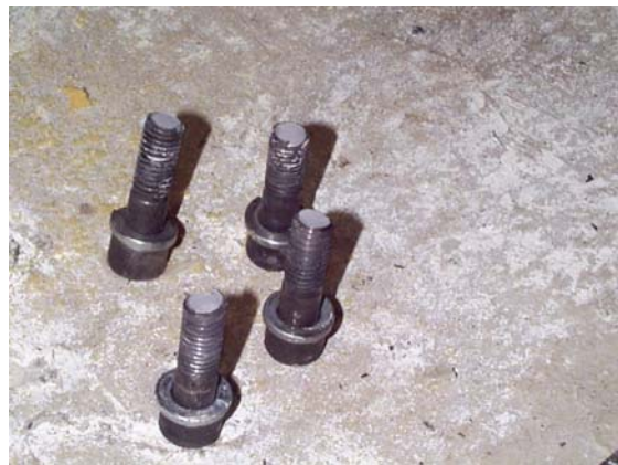
(d) Failure of Shear Connectors
