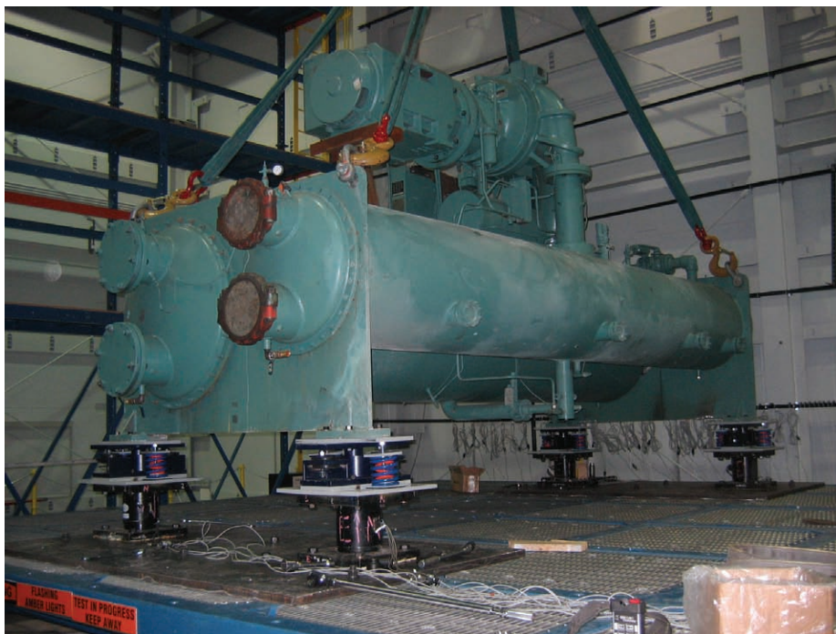
(d) Chiller Mounted on I/R Systems
