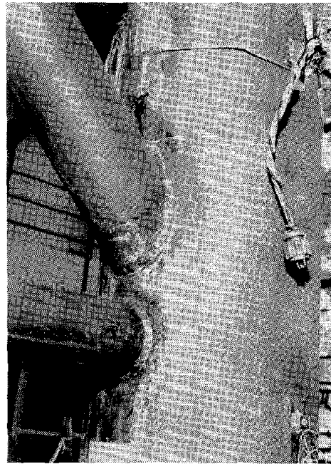
(d) Yielding of the Lower Diagonal & Horizontal Braces
