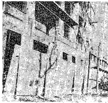
图27 新华旅馆门厅入口处雨棚倾复的状态
