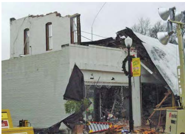
2003年12月22日 San Simeon 地震之后 Paso Robles 市中心的倒塌屋顶。两个人从建筑物向外跑时被掉下的碎片砸死。(USGS photo)
